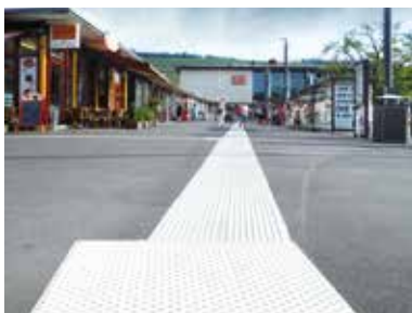
Bahnhof, Würzburg (DE) • Objekt: Bahnhofsvorplatz • Objektgröße: 275 m Rippenmarkierung • Systeme: Triflex Taktile Markierung, Triflex Line Kaltplastik, Preco Cryl Profilplastik 2K
