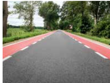
K40, Halle/Getelo (DE) • Objekt: Fahrradschutzstreifen • Objektgröße: 7,0 km • Systeme: Triflex Preco Line 300, Triflex Line Kaltplastik
